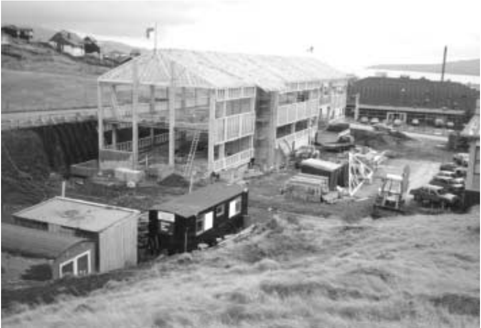
Sjóvinnubankin fór undir at byggja sær nýtt høvuðssæti í Húsagøtu í Havn í 1985. Her eru húsini reist. Tíggju ár seinni gjørdist bygningurin høvuðssæti hjá samanlagda Føroya Banka
